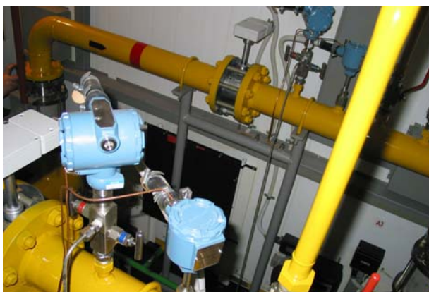
УЗЕЛ УЧЕТА ГАЗА. ВИД ВНУТРИ
